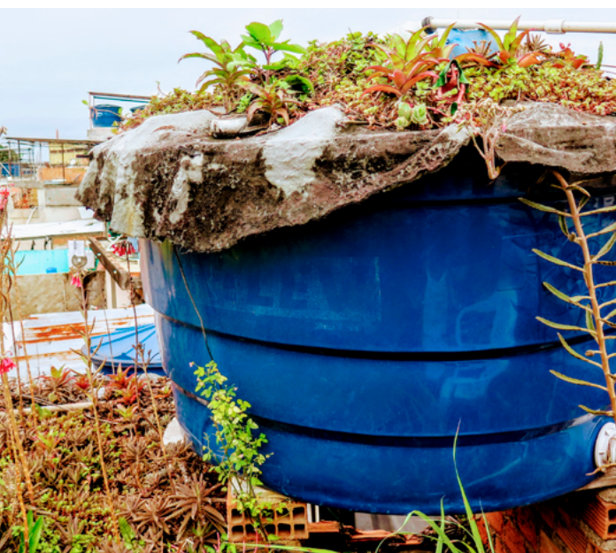
Figura 3. Telhado verde em Manguinhos, no Rio de Janeiro (RJ). Intercâmbio da Rede Favela Sustentável com o Atelier do Hadasha e com o projeto Teto Verde Favela. Fonte: CatComm | ComCat | RioOnWatch. Licença CreativeCommons CC BY-NC- SA 2.0.
