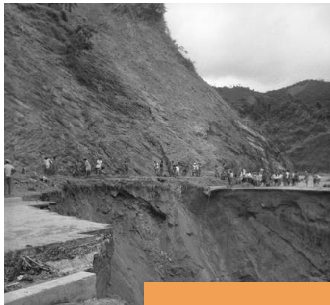
Figura 20. Trecho da Rodovia Presidente Dutra rompido por deslizamento em 1967. Foto: José Vasco. Fonte: O GLOBO, 2017.
