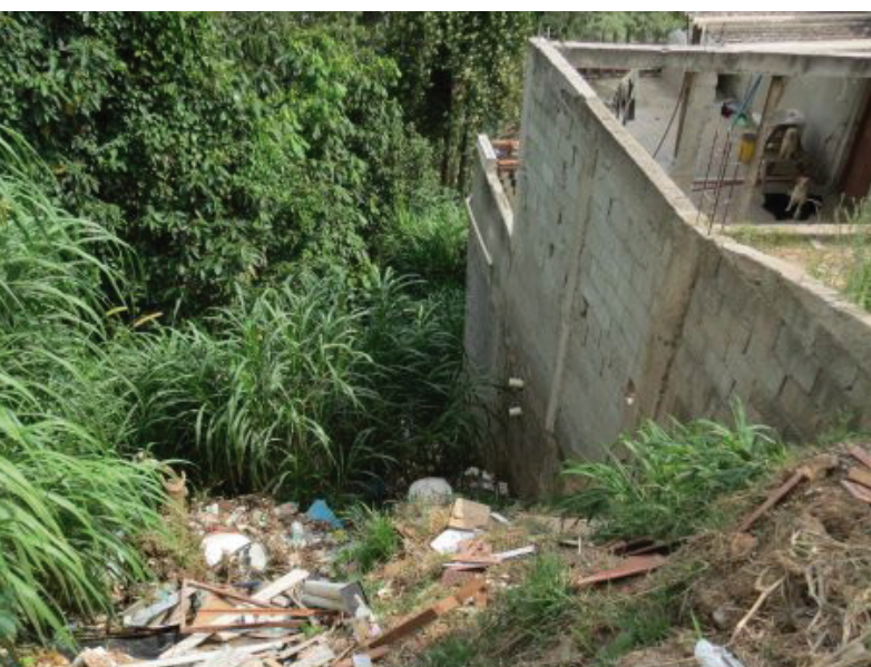
Figura 14. Lançamento de lixo e entulho em talude de alta declividade. Fonte: LabGRis, 2020.
