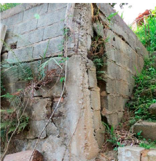
Figura 5. Muro embarrigado. Fonte: LabGRis, 2020.
