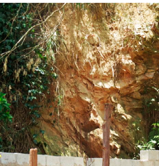
Figura 8. Desconfinamento da foliação e fraturas do filito que desfavorecem a estabilidade do talude quando são executados cortes. Na imagem pode-se observar o deslocamento do material. Fonte: LabGRis, 2020.
