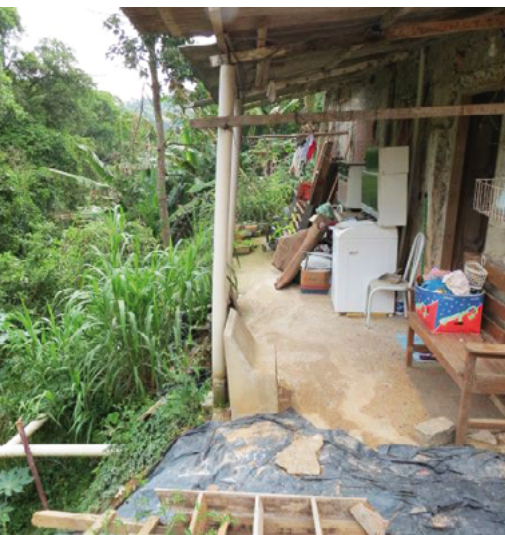
Figura 12. Edificação com baixo padrão construtivo. Com a ausência de calhas, a água de chuva é lançada diretamente no talude adjacente à edificação. Fonte: LabGRis, 2020.
